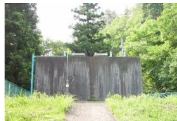
第8水源受水槽（新鶴地域）
