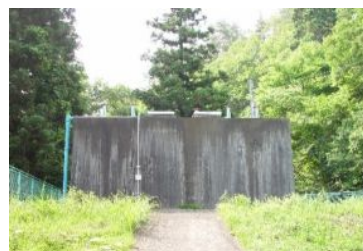
第8水源受水槽（新鶴地域）
