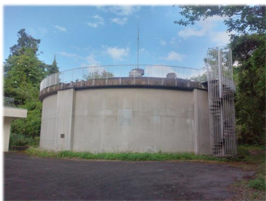
虫掛配水池(高田地域)
