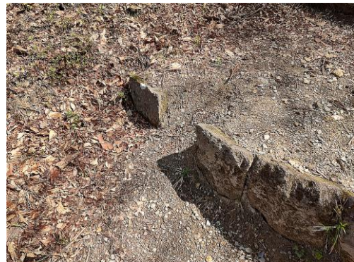
破損している遊歩道
