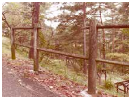
▲白鳳山公園アスレチック駐車場の木柵。老朽化により各所が折れています。(R4.10月現在)
