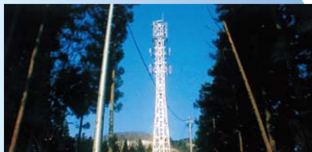
尾岐携帯電話基地局完成
