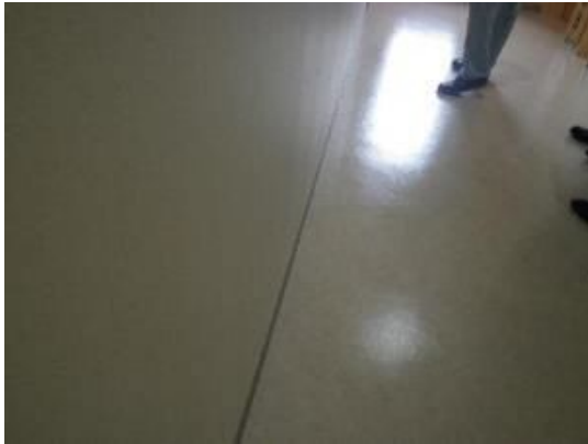
2階廊下(5) 巾木取り合い部分の床の色が違う
