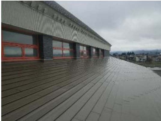
南面ホール棟屋根 屋根材がゆがんでいる
