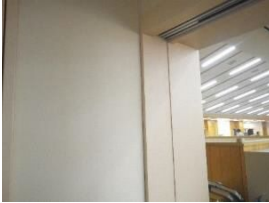
2階廊下(5) 建具上部入隅部のすきま
