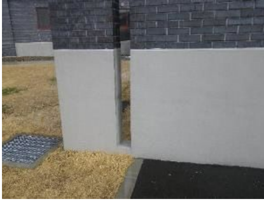
車寄せ腰壁 腰壁薄塗材の乾燥収縮によるひび割れ
