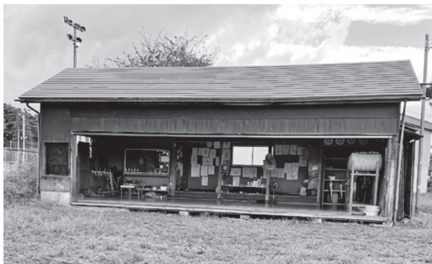
練習に支障がないように早急な改修を望む
