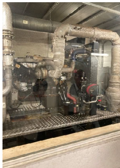
上野村木質バイオマス発電施設
